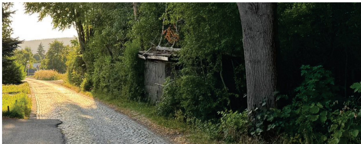
Ein Schuppen aus Restbeständen der vorhergegangenen Nutzungen. Derzeit ohne Nutzung und abbruchreif.
